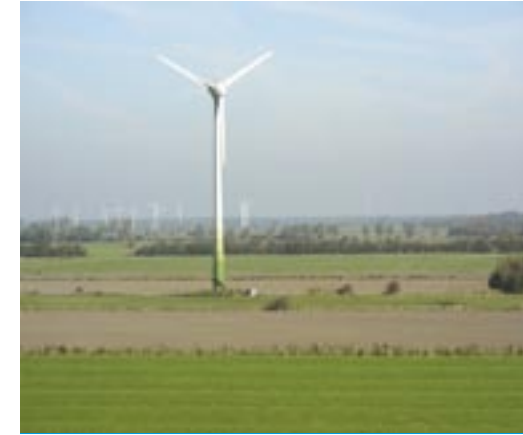
Parc éolien du nord de l'Allemagne. Sérotine (Eptesicus serotinus) et Pipistrelle (Pipistrellus pipistrellus) utilisent régulièrement ce paysage structuré pour chasser. Pour éviter la mortalité, il convient de respecter la distance minimale de 200 m par rapport aux structures paysagères. © Lothar Bach
