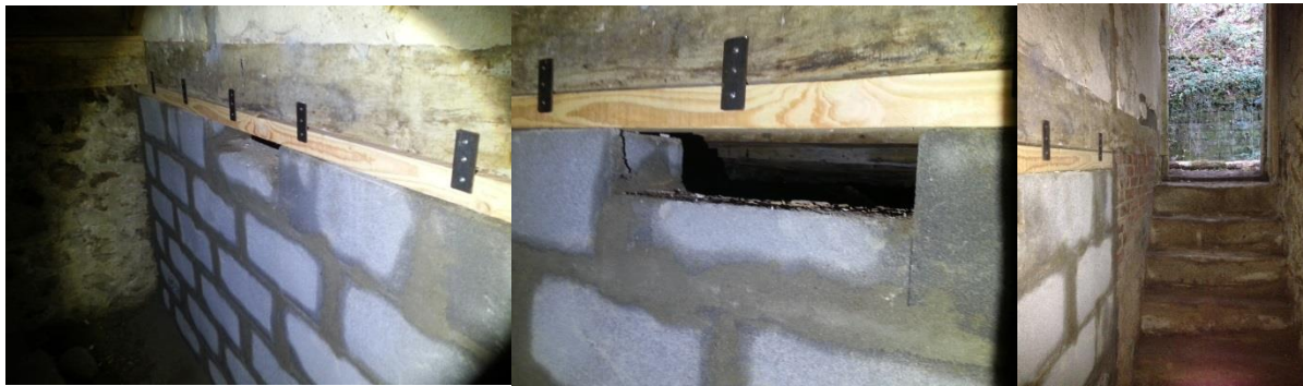
Pose d'un mur dans la cave pour éviter les courants d'air et les intrusions. Ouverture pour les chauves-souris
