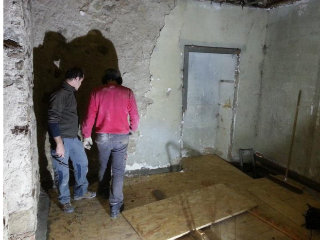
Pose d'un plancher en OSB entre le rez de chaussée et la cave
