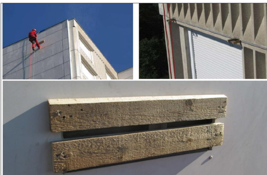
Intégration d'un gîte de substitution en façade d'immeuble à Besançon (25), avant colmatage des accès aux joints de dilatation et vides sanitaires qui permettaient à une colonie de Pipistrelles de rejoindre les cloisons intérieures (Attention dans ce type de dispositif à bien veiller à l'absence de nuisance pour les habitants). (Sources : CPEPESC Franche-Comté)
