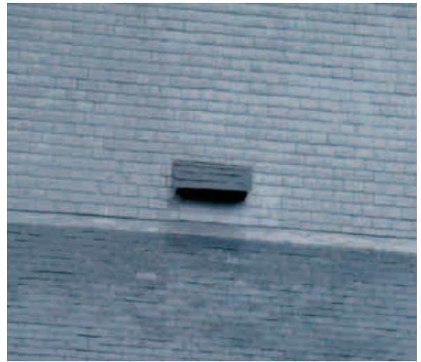
Chiroptière intégrée par les architectes de la Direction des Monuments, Sites et Fouilles dans le plan de restauration de l'église classée de Sensenruth, province de Luxembourg (J. Fairon)
