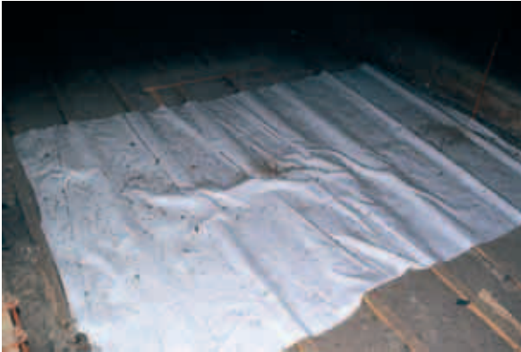
Traces de chauves-souris sur ZT (bâches en plastique) (J. Fairon)
