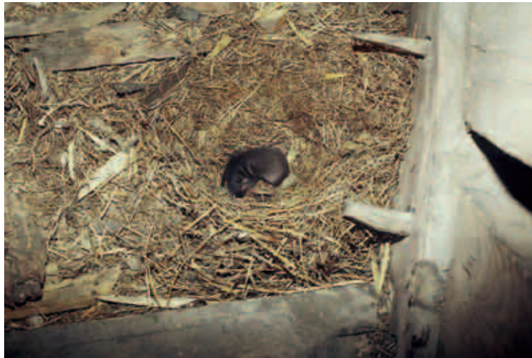
Nid de fouine avec un jeune, sur un mur porteur dans les combles (J. Fairon)
