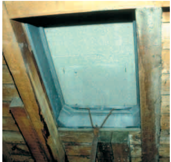
Tabatière dont la vitre a été remplacée par un carreau d'éternit (J. Fairon)
