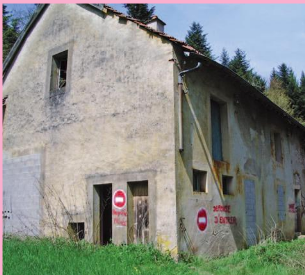
Un bâtiment trop délabré ne permet parfois pas de pouvoir le maintenir pour des questions de sécurité et de coût de remise en état - maison forestière de Boudouze (Meurthe-et-Moselle). © Christophe Coutiéras/ONF.
