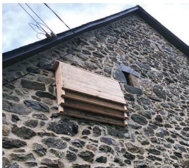
Le nichoir multi-couches est une version "luxueuse" du nichoir plat de façade. Il a l'avantage d'offrir encore plus d'accueil pour les chauves-souris - maison forestière du Pestre (Cantal). © Thomas Darnis/ONF
