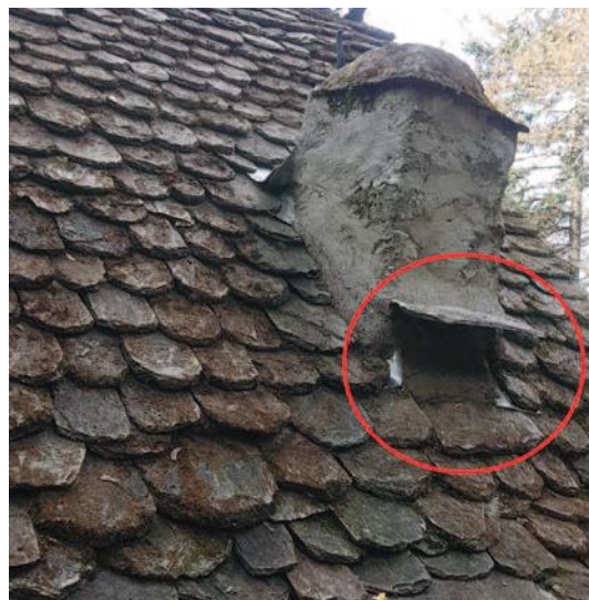
Une autre manière de poser une chiroptière : à travers la toiture. Ici à la base d'une cheminée. Abri forestier de Bramont (Lozère). © Martin Delaunay /animateur site Natura 2000 Valdonnez
