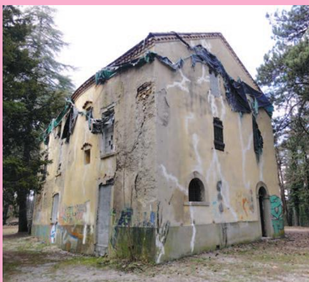
Le délabrement de l'étanchéité des toitures est à l'origine des premiers désordres dans la maçonnerie des murs - château de Pelicier (Alpes-de-Haute-Provence). © Eric Daguillon, architecte.
