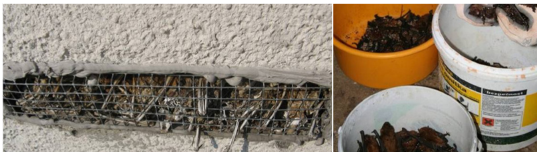
Figure 6. À gauche : des centaines de chauves-souris enfermées pendant des travaux de rénovation et d'isolation. À droite : Ces individus en hibernation découverts lors de l'isolation ont été placés dans des seaux et abandonnés par les ouvriers du chantier. Avec l'aimable autorisation de ČESON et ZO ČSOP Nyctalus.
