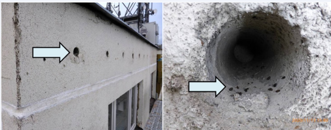
Les gîtes occupés par des chauves-souris dans les conduits de ventilation peuvent être identifiés par le guano. Avec l'aimable autorisation de Martin Celuch (SON).
